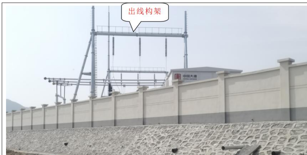
图2-1 本溪大唐储能升压站（起点）
